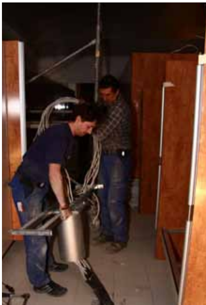
Installation der Tragsäule: Die Grundkonstruktion fungiert gleichzeitig als Kabelkanal
